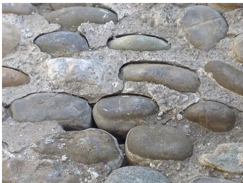
Abb.15: Risse in die Wasser eindringt
