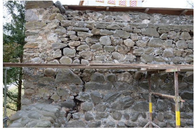
Abb.46: freigelegter Riss an Mauerecke
