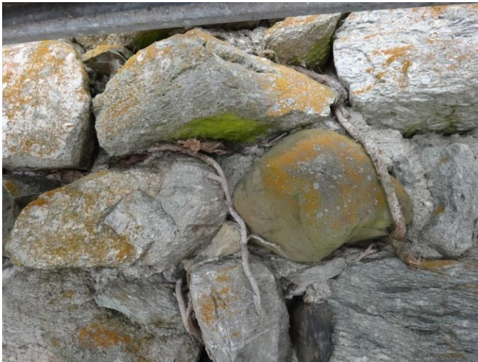
Abb.11: Schadensbild an der Südwestseite
