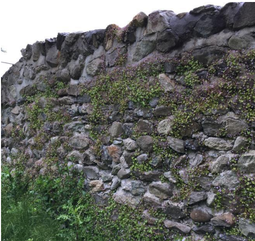
Abb.42: Fugenmörtel fehlt grossflächig und der Pflanzenbewuchs ist ausgeprägt.
