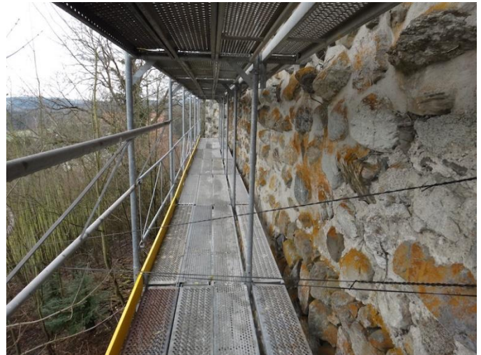
Abb.12: Biogener Befall an der Nordostseite
