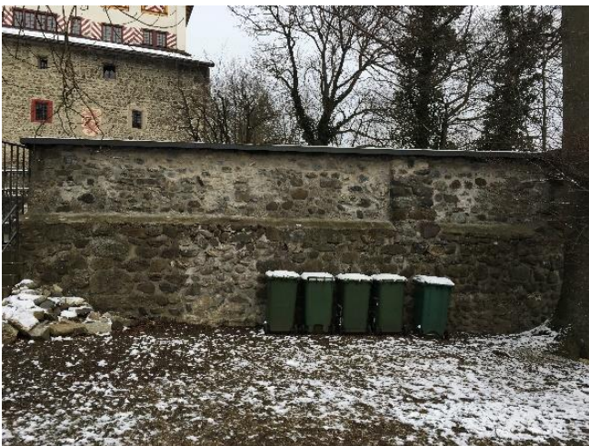
Abb.49: Aussenseite vor der Sanierung
